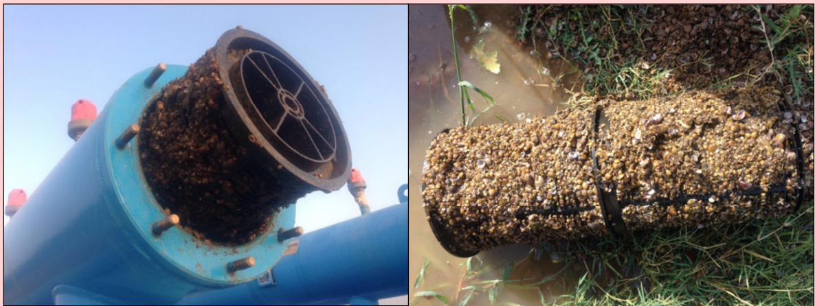
Ilustración 2: Almejas asiáticas taponando las infraestructuras de riego.
